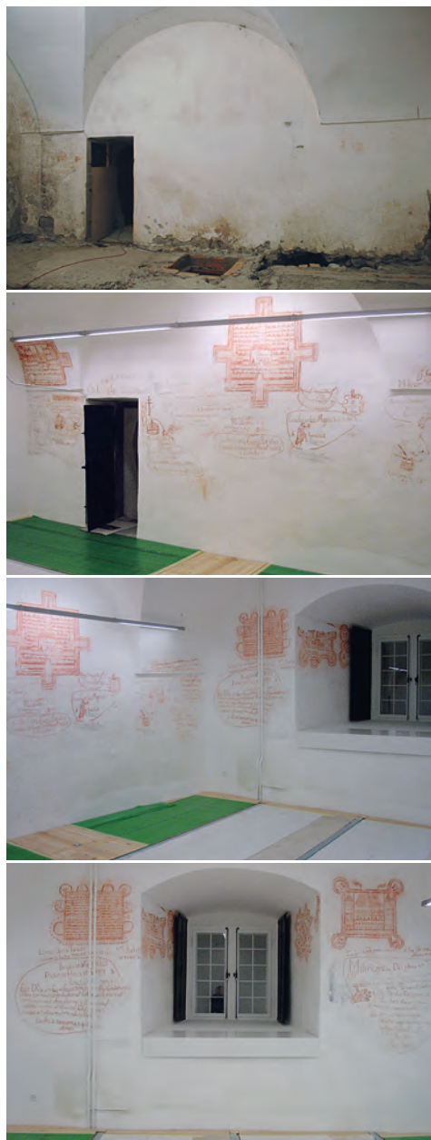
Abb. 67: Chur, Bischöfliches Schloss, Marsölturm. Ansichten der West- und Nordwand vor und nach der Restaurierung.
